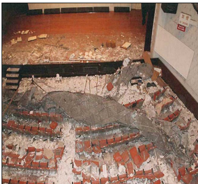
東日本大震災による九段会館天井崩落事故の様子 (出典：国土交通省)
